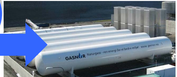
Onshore LNG bunkering Station
